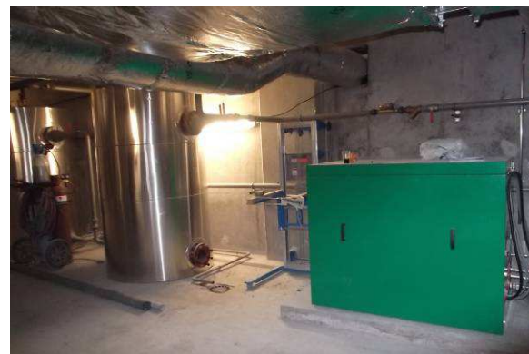
La cogénération à huile végétale
